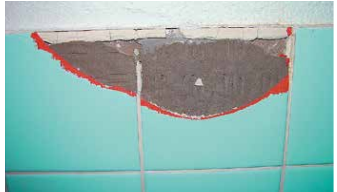
In Gebäuden, die vor 1990 gebaut wurden, muss man mit Asbest rechnen.
