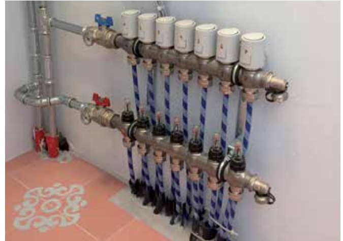
Heizkreisverteiler mit Stellantrieben und Basiseinheit
