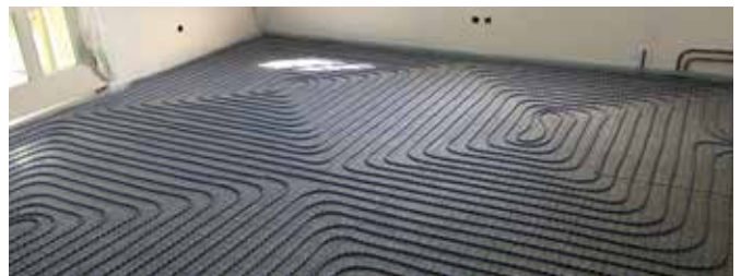
Die verlegten Heizrohre beim System ab 14 mm
