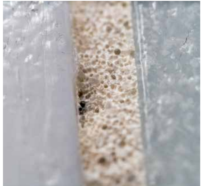
Epoxyfuge mit Schimmelpilz. Die offenen Poren entstanden durch zu hoch dosierten Javelwasser-Einsatz. Die Glasur wurde durch die Reinigung mit der Stahlbürste zerstört.
