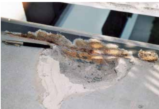
I fenomeni di corrosione sono limitati all'area di contatto fra le piastrelle e la struttura in acciaio.
