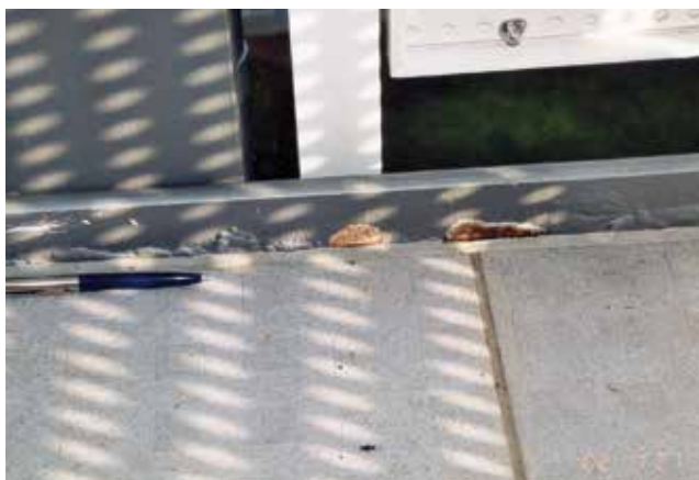
Schadenbilder: Originalzustand, nach dem Entfernen der Bodenplatten, nach dem Entfernen des Bodenaufbaus bis Oberkante Beton.
