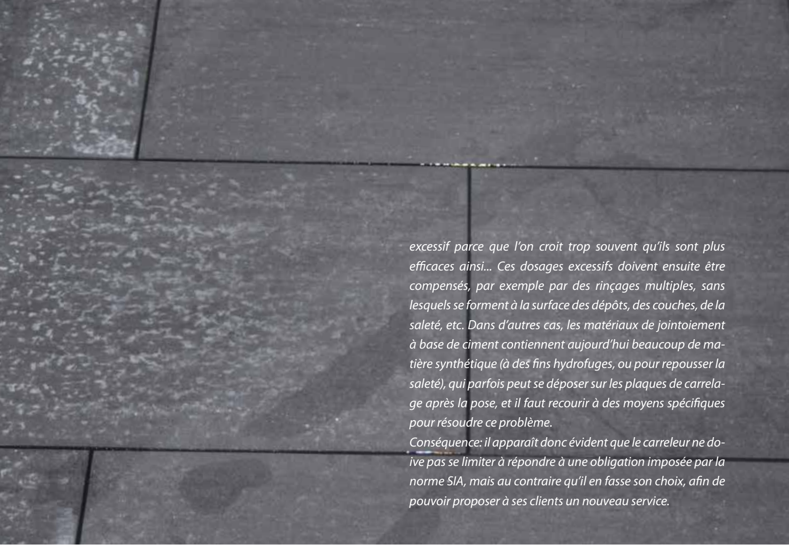
Kalkrückstände auf einer strukturierten Platte in einer Dusche.
